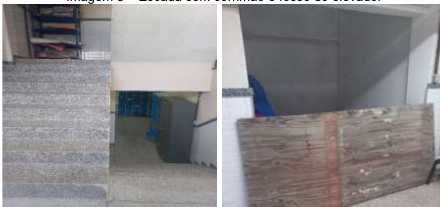
Imagem 5 – Escada sem corrimão e fosso do elevador
